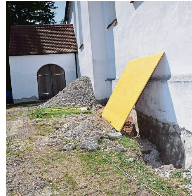
Das Kirchenfundament muss trockengelegt werden.
